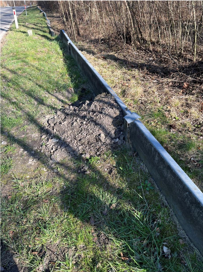
Abbildung 6: Nicht normgerechte Ausführung und unzureichende Hinterfüllungen
