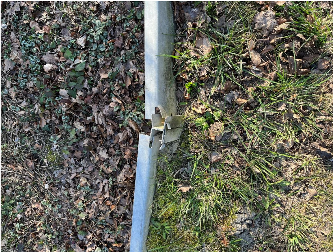
Abbildung 5: Scharfkantige Stellen der permanenten Amphibienschutzanlage
