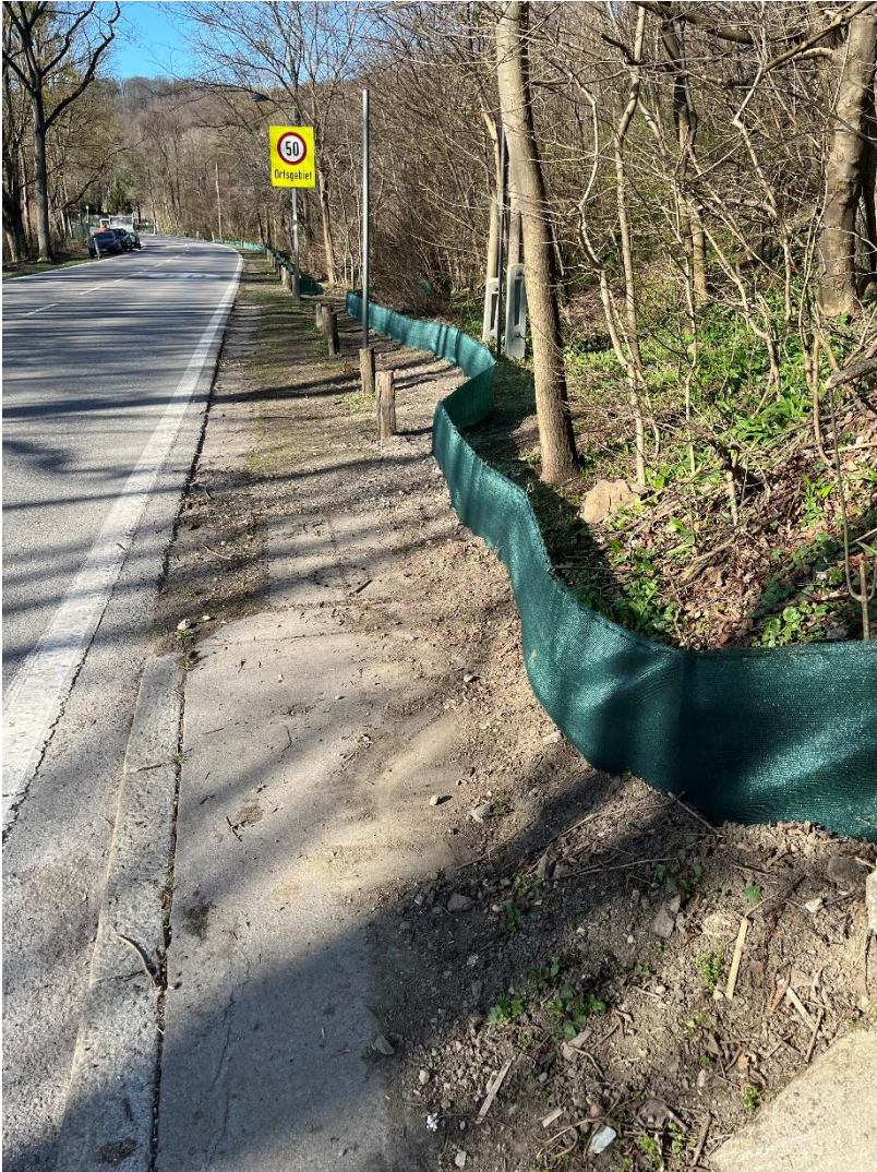
Abbildung 1: Neue temporäre Amphibienschutzanlage in Wien 14, Mauerbachstraße
