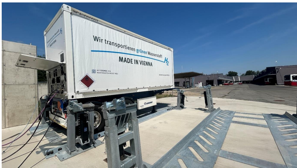
Abbildung 2: Aufstellplätze mit Wasserstoffcontainer auf Trailer
