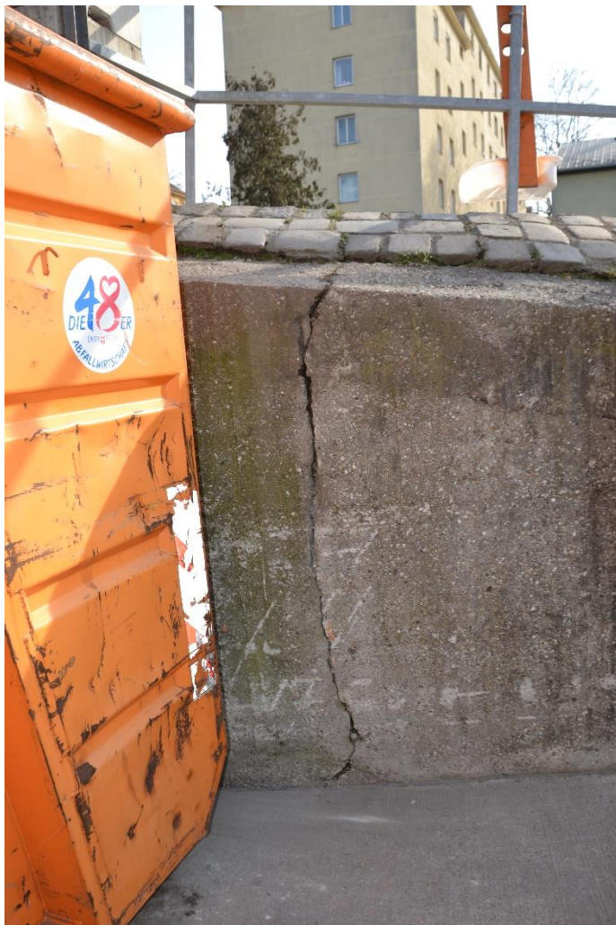
Abbildung 5: Riss in einer der Stützmauern
