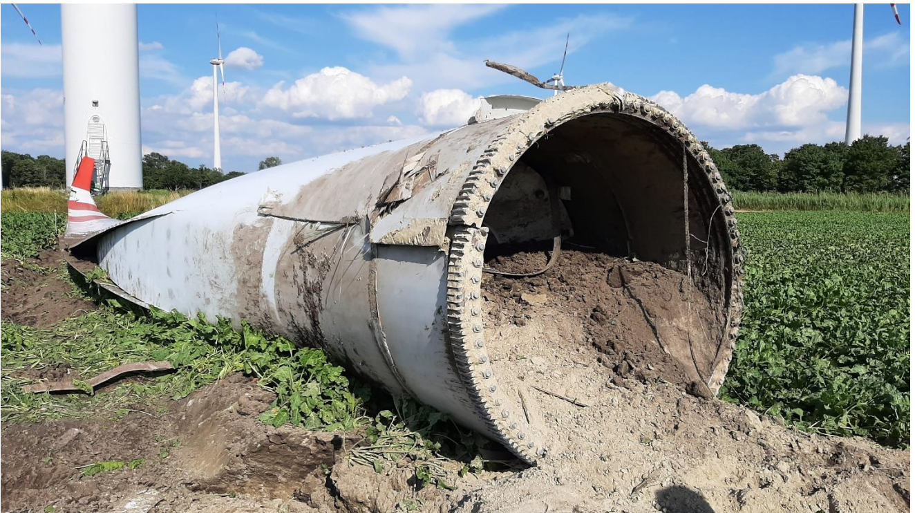
Abbildung 16: Abgebrochenes Rotorblatt der Windenergieanlage WEA-G2 im Windpark Glinzendorf I
