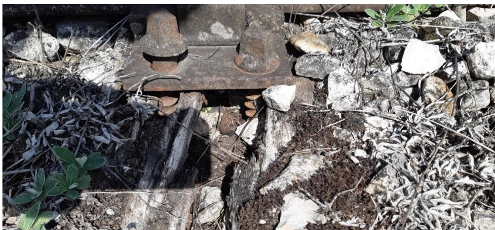
Abbildungen 7 und 8: Schadhafte Schienenbefestigungen
