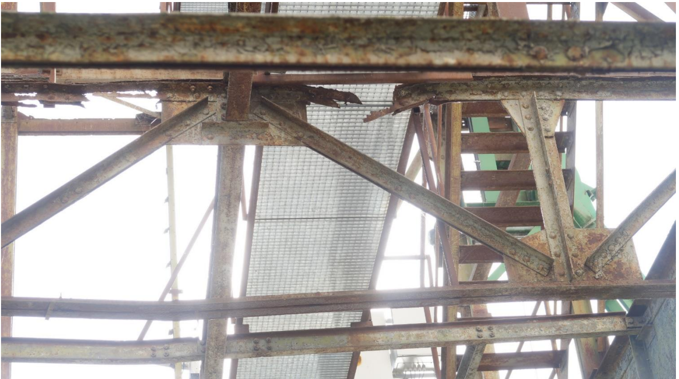
Abbildung 3: Schäden an der Stahlkonstruktion des Verladeturms
