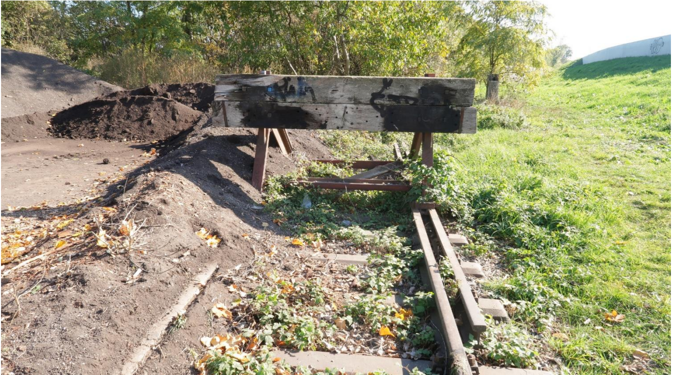
Abbildung 4: Teilweise zugeschüttete Gleisanlage im Bereich eines Prellbockes
