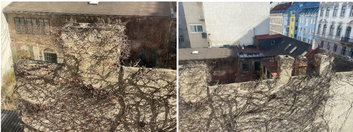
Abbildung 6: Schäden an der Feuermauer
