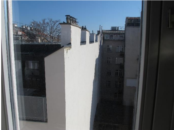
Abbildung 7: Schäden an der Feuermauer
