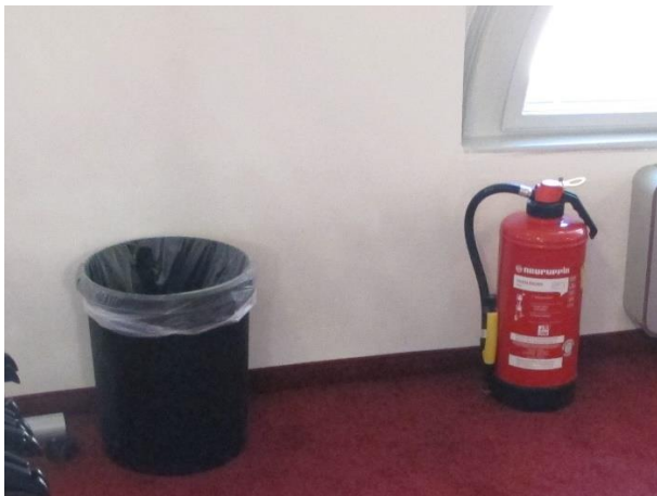
Abbildung 2: Ungesichert abgestellter Handfeuerlöscher
