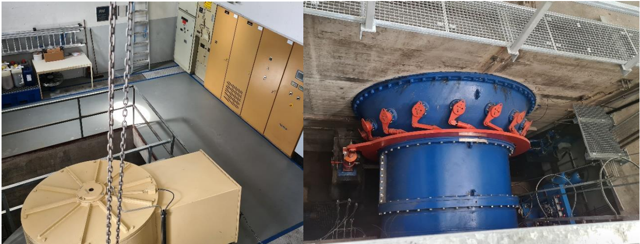
Abbildung 13: Kraftwerk Mürzhofen - Innenansicht
