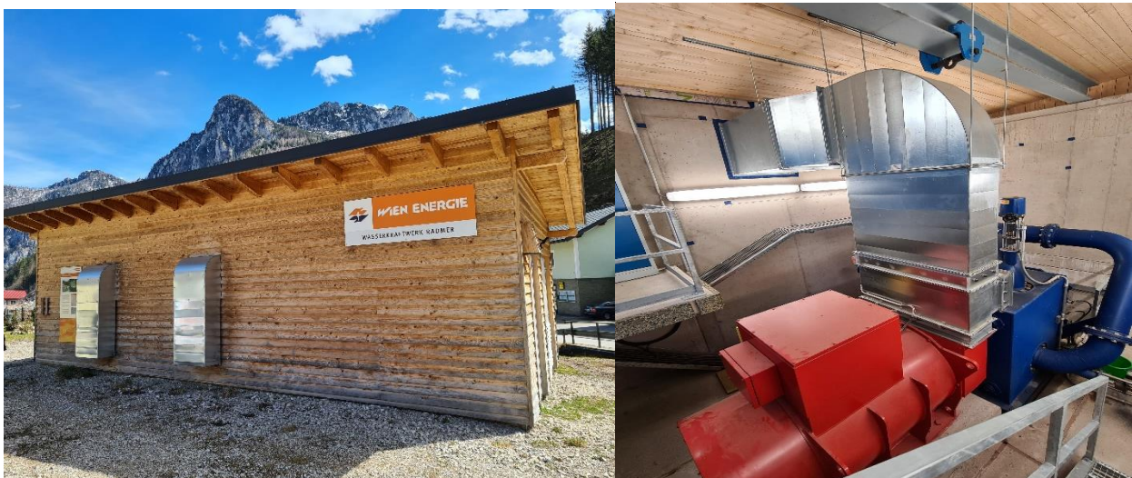
Abbildung 3: Kraftwerk Radmerbach - Krafthaus
