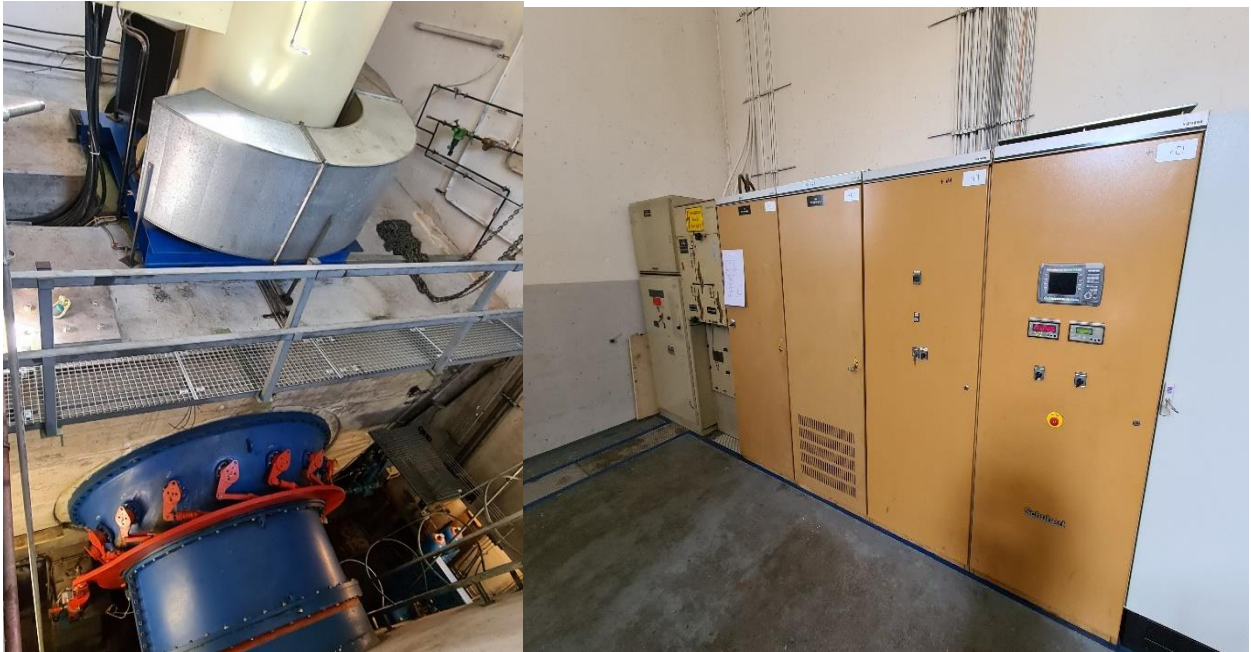
Abbildung 16: Kraftwerk Kindberg-Aumühl - Innenansicht
