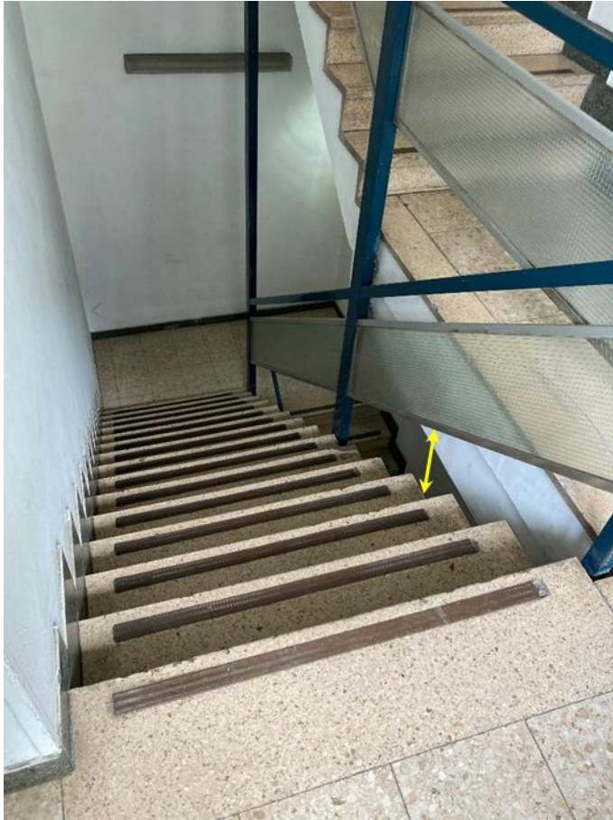
Abbildung 6: Absturzsicherung im Stiegenhaus der MVA Flötzersteig
