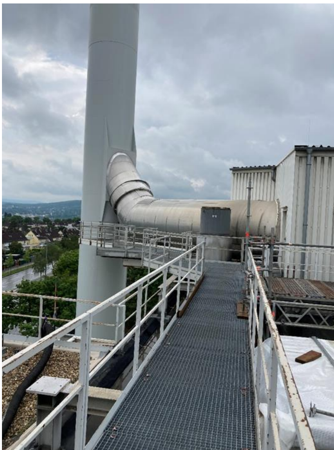
Abbildung 5: Einmündung des Rauchfanges in den Schornstein der MVA Flötzersteig
