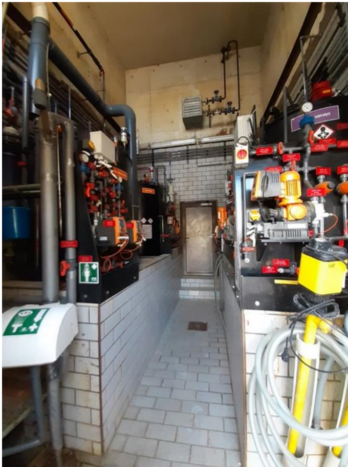
Abbildung 2: Chemikalienstation der MVA Flötzersteig
