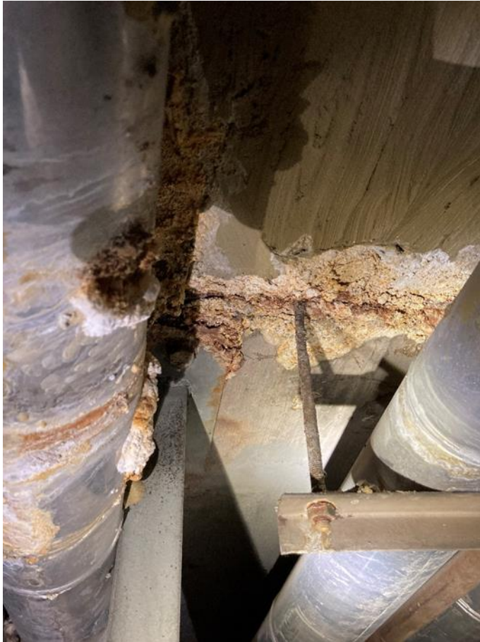
Abbildung 8: Feuchtigkeitseintritte und Korrosionsschäden im Kollektorgang der MVA Flötzersteig
