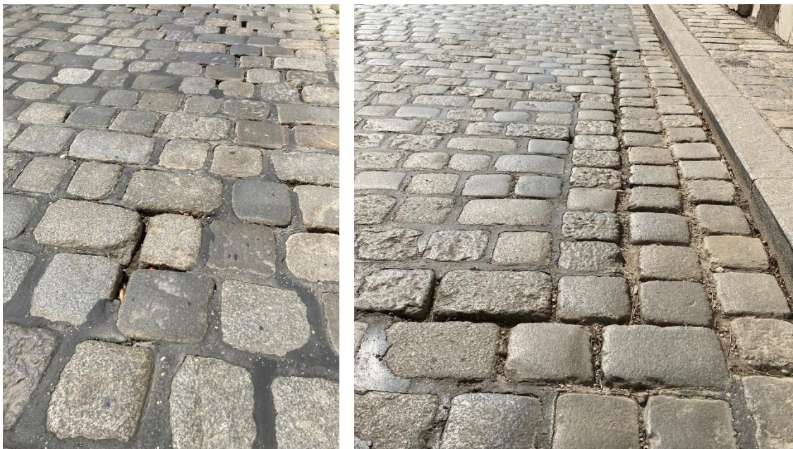
Abbildung 16: Offene Fugen der Pflastersteindecke in der Kahlenberger Straße 11 bzw. 14
