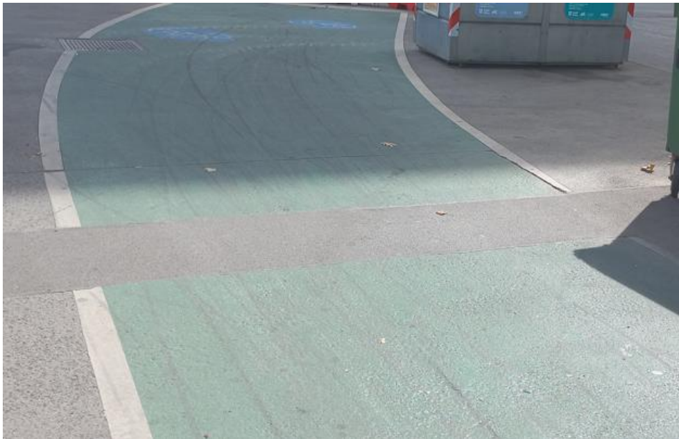
Abbildung 2: Belag und Bodenmarkierung nach Aufbruch nicht ergänzt
