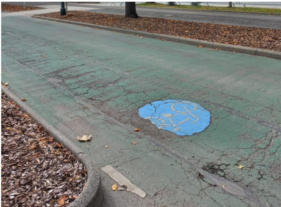
Abbildung 3: Belag und Bodenmarkierung abgerieben, Oberfläche gerissen
