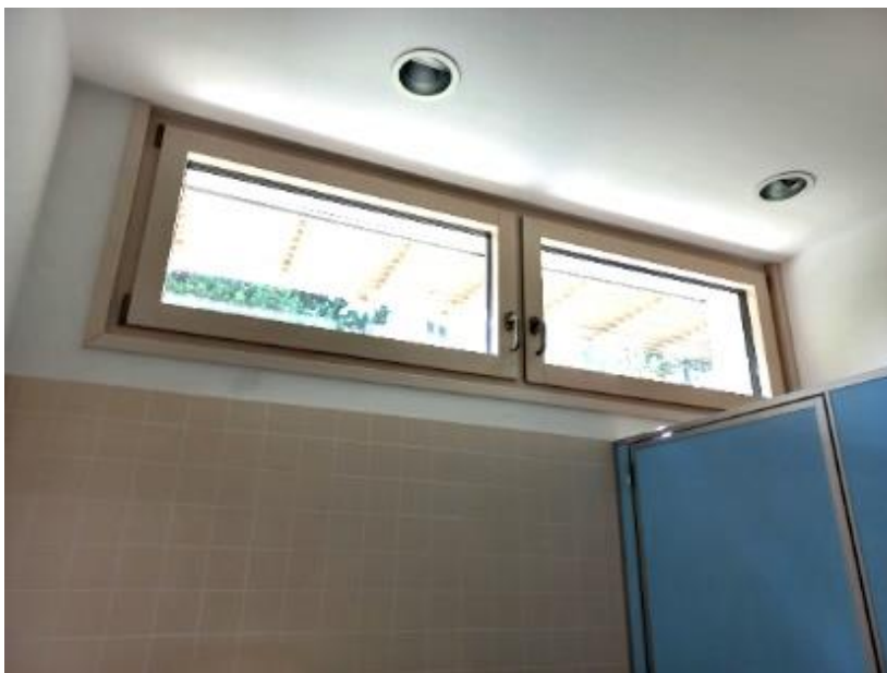
Abbildung 4: Oberlicht mit schwer zu erreichenden Fenstergriffen
