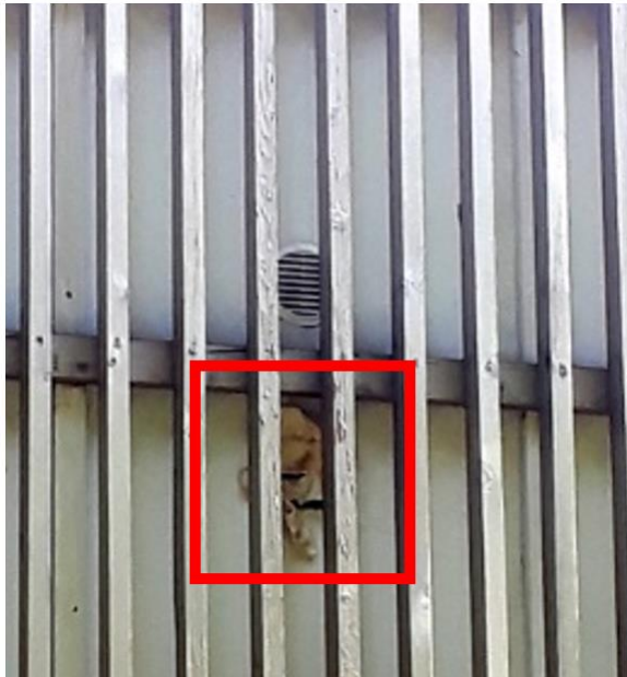
Abbildung 5: Nicht fachgerechte Abdeckung einer Öffnung in der Fassade
