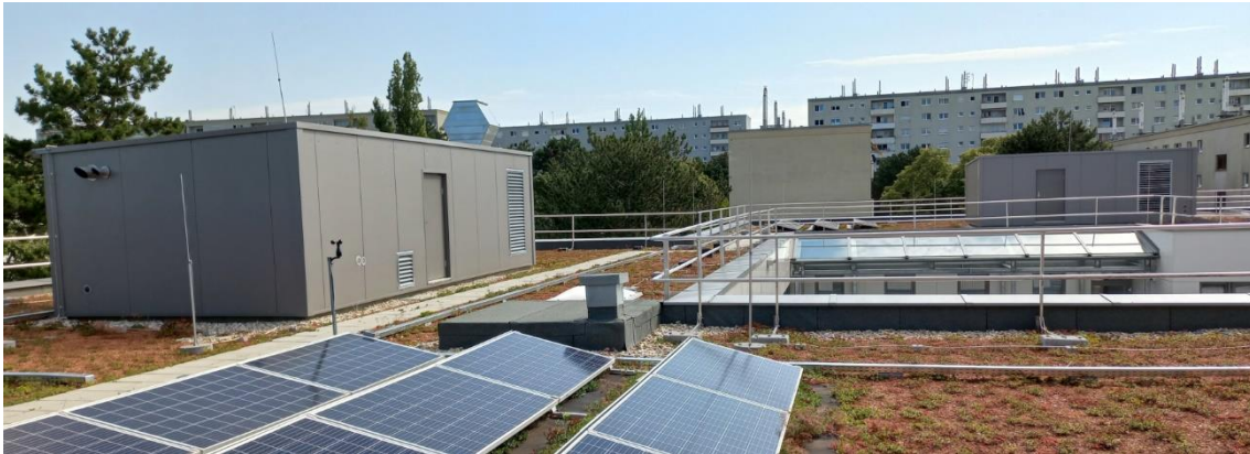
Abbildung 8: Lüftungszentralen am Flachdach des Kindergartens
