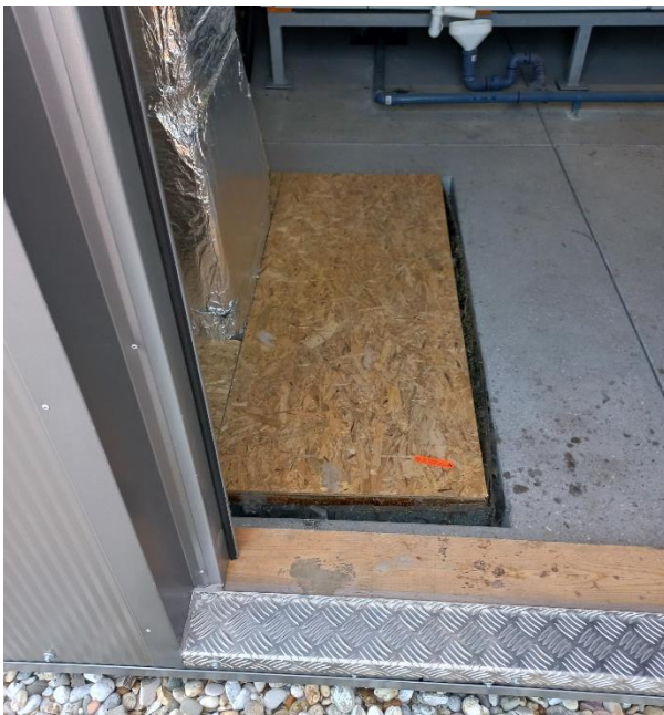
Abbildung 9: Stufe im Fußboden einer Lüftungszentrale hinter der Türschwelle
