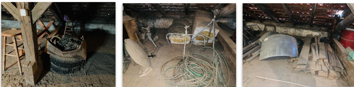
Abbildungen 6, 7 und 8: Leicht entzündliche Lagerungen am Dachboden
