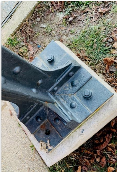
Abbildung 9: Stütze mit fehlender Verschraubung an der Metalltreppe
