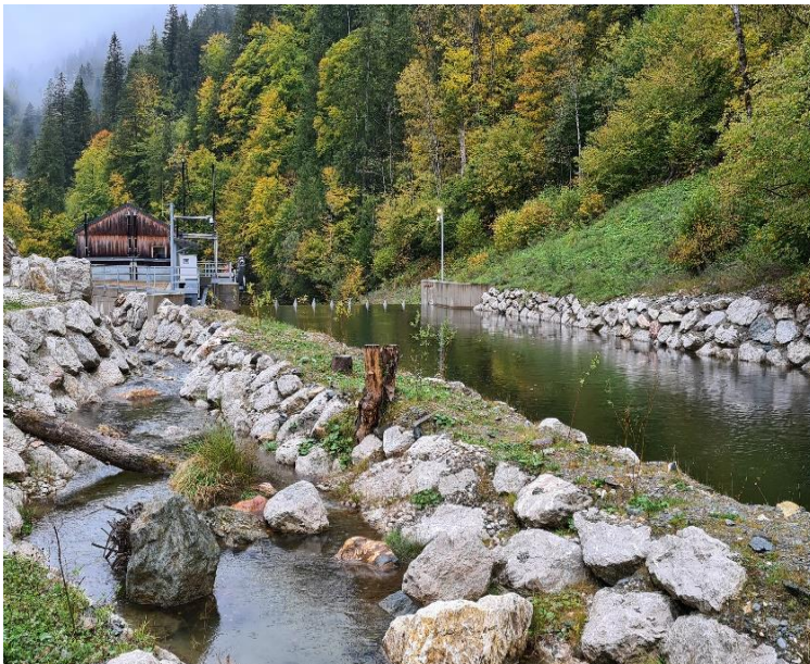
Abbildung 11: Wehranlage mit Staubecken rechts und oberer Teil der Fischwanderhilfe links sowie Wehrhaus hinten
