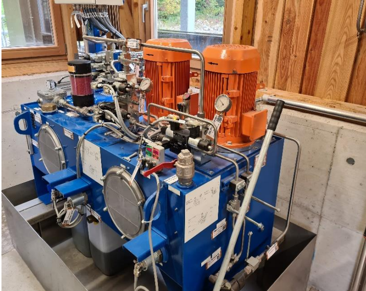
Abbildung 10: Wehrhydraulik im Wehrhaus
