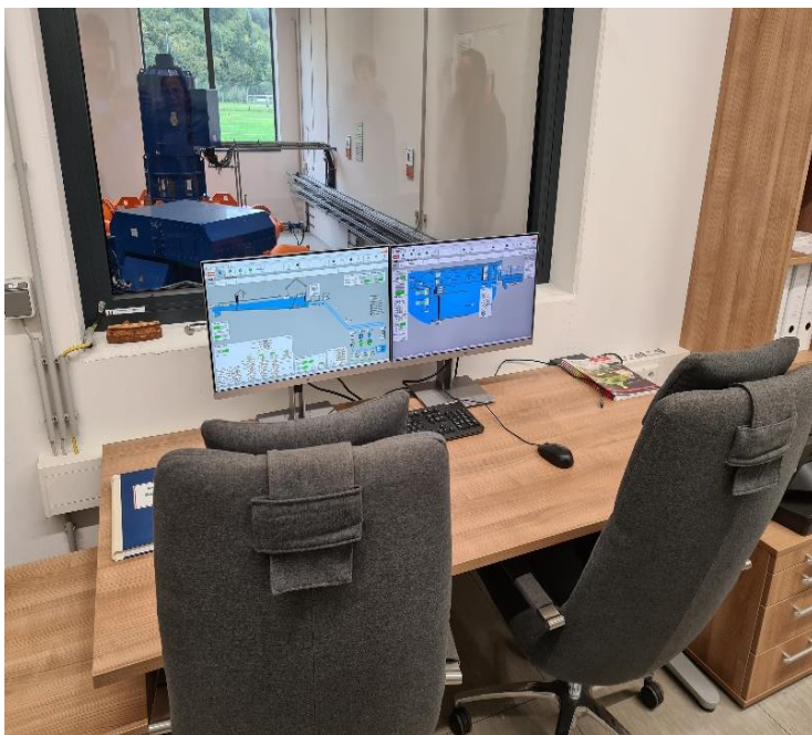
Abbildung 7: Kraftwerkshaus Innenbereich: Lokale Wartestation
