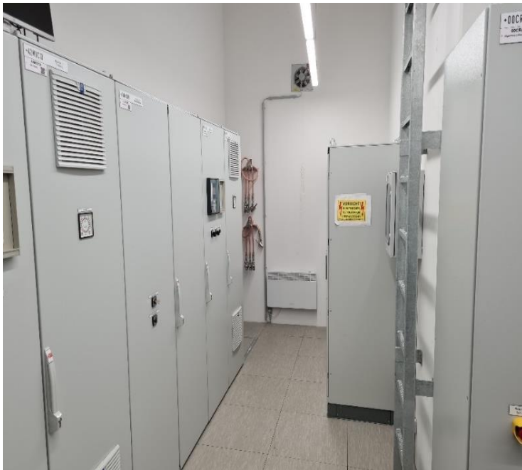
Abbildung 6: Kraftwerkshaus Innenbereich: Schaltschranke mit Leistungsschaltern
