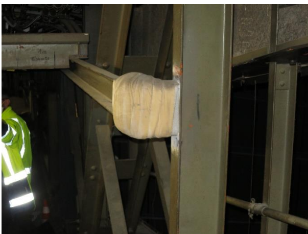
Abbildung 13: nicht gekennzeichnete Gefahrenstelle
