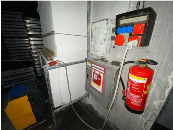
Abbildung 8: Anschluss eines Gabelstaplerladegeräts
