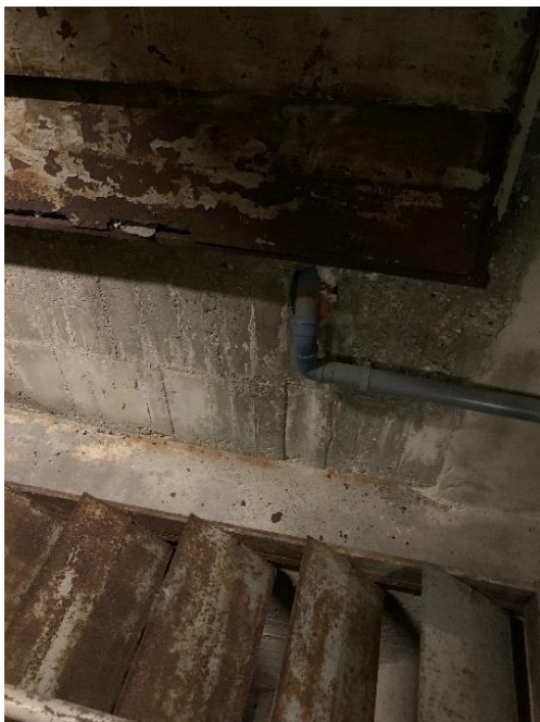
Abbildung 18: stark korrodiertes Zuluftklappenelement
