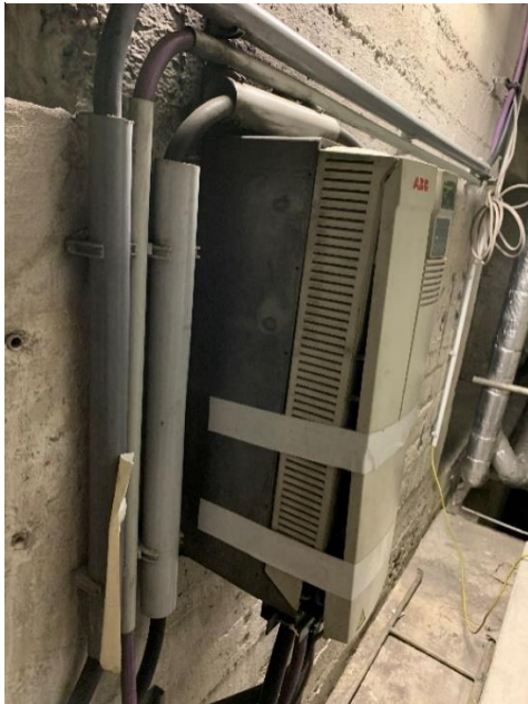
Abbildung 7: beschädigtes Gehäuse einer Motorantriebssteuerung (Frequenzumrichter)
