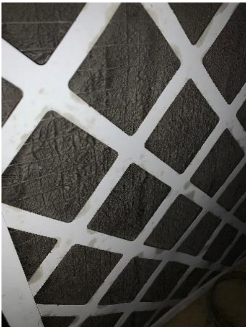
Abbildung 16: verschmutzter Lüftungsfiter (Filterkassette)
