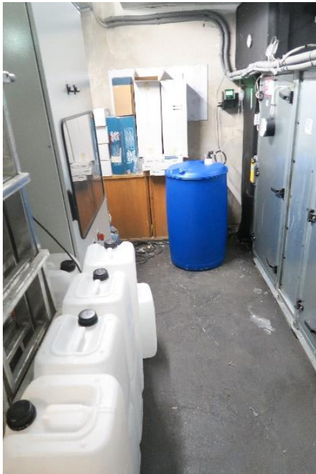
Abbildung 19: Trinkwasserdesinfektionsanlage samt Chemikalienbehälter
