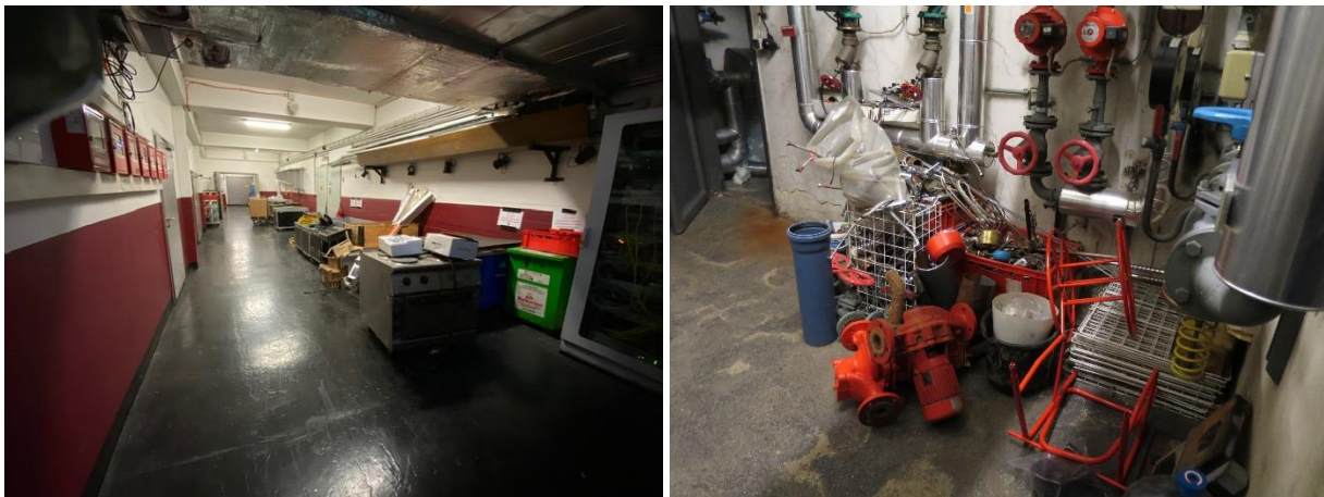
Abbildung 10 und 11: Lagerungen im Gang zur Notstromversorgung und in einem Technikraum
