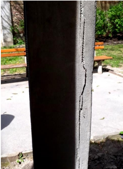
Abbildung 11: Risse in einer Betonsäule der Mosaikwand "Lebensrhythmus"
