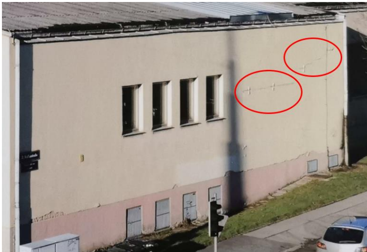
Abbildung 5: Risse am Trakt Kafkastraße
