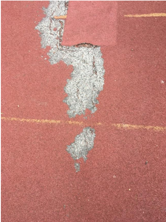
Abbildung 8: Desolater Belag des Sportplatzes, Schulstandort 2
