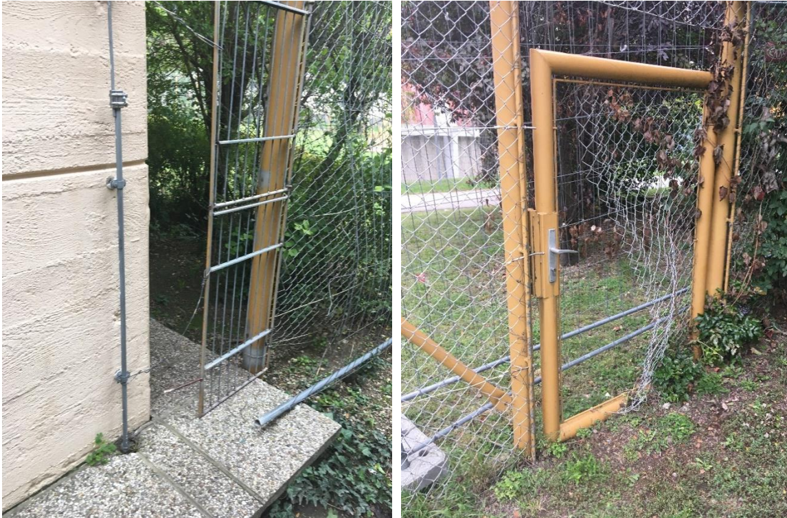
Abbildung 23: Desolate Einfriedung, Schulstandort 6
