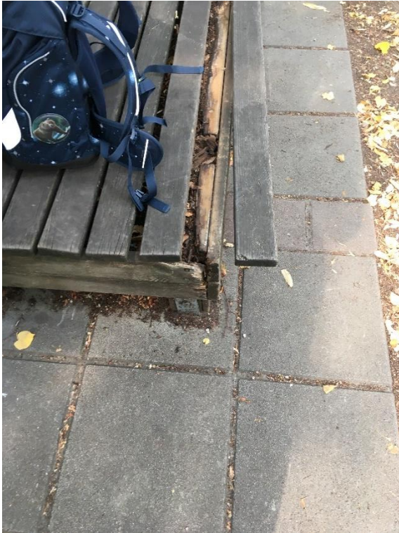
Abbildung 9: Schadhafte Sitzbank an der Umrandung des Sportplatzes, Schulstandort 2
