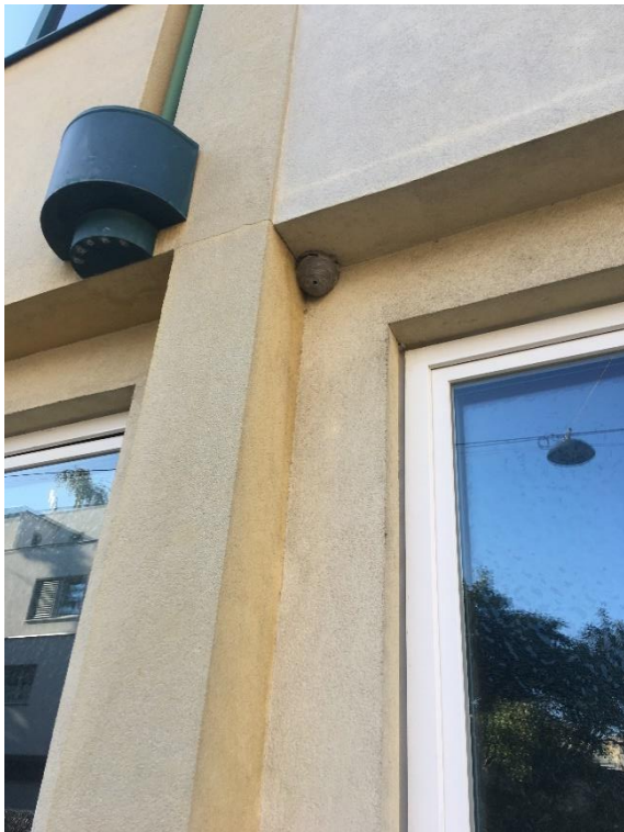
Abbildung 6: Aktives Wespennest an der Schulfassade, Schulstandort 1
