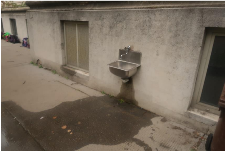
Abbildung 19: Undichter Abfluss an der Fassade des Schulgebäudes, Schulstandort 4
