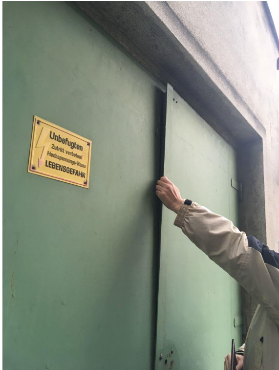
Abbildung 29: Schlecht schließende Tür bei der Transformatorenstation im Schulpark, Schulstandort 9
