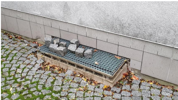
Abbildung 34: Abgesenkter Bodenbelag mit herumliegenden Steinen, Schulstandort 10
