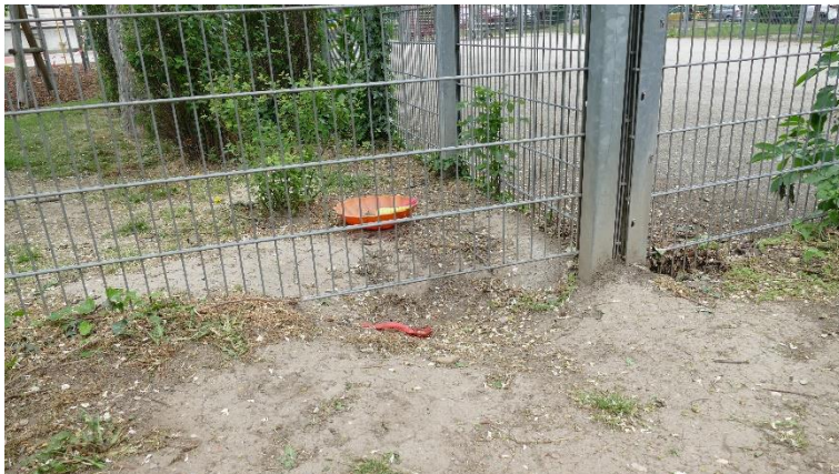
Abbildung 17: Untergrabene Zaunanlage, Schulstandort 4
