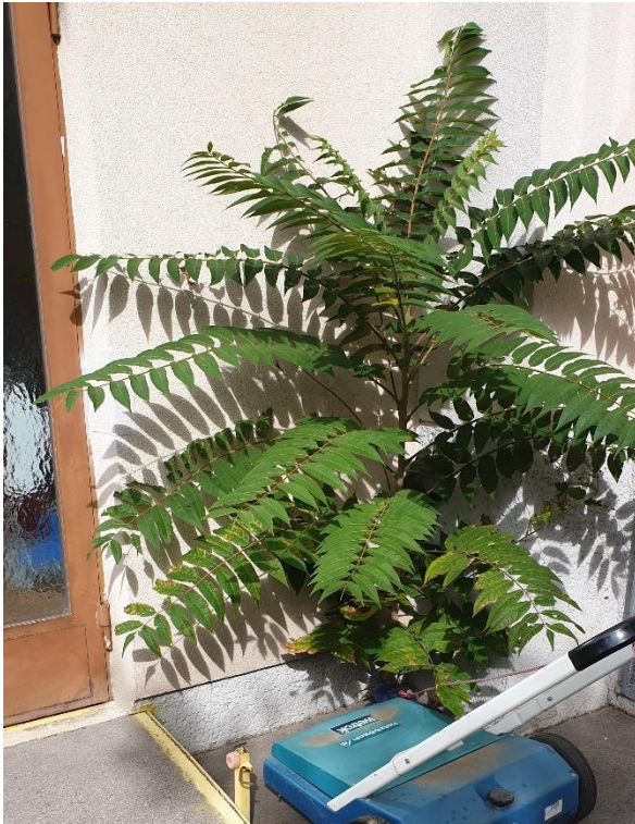
Abbildung 4: Götterbaum in der Fuge an der Hausfassade, Schulstandort 5
