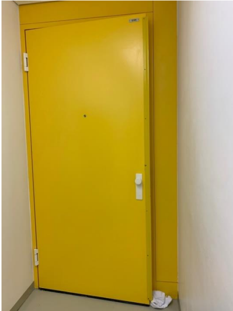
Abbildung 2: Blockade einer Brandschutztüre Ebene 13
