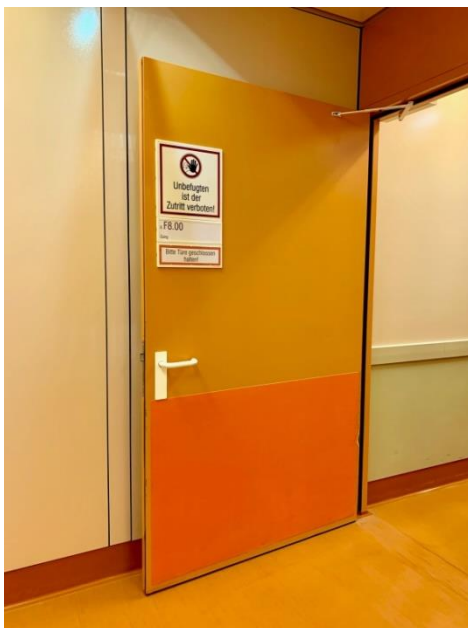
Abbildung 1: Offenstehende Türe auf Ebene 8
