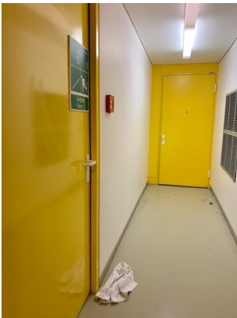
Abbildung 3: Vorbereitung einer Türblockade im Fluchtweg Ebene 13
