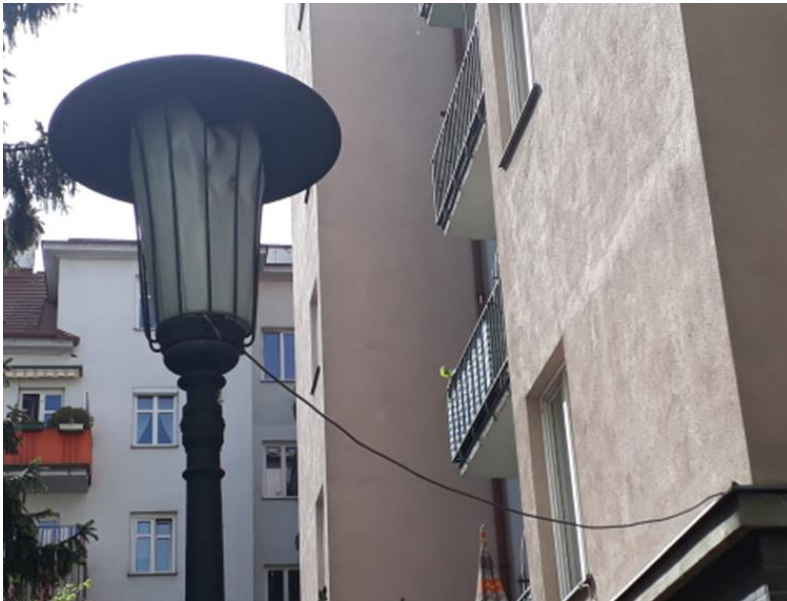
Abbildung 7: Loses, im Freien zwischen Hausfassade und Leuchte gespanntes Stromkabel zur Versorgung einer Leuchte
