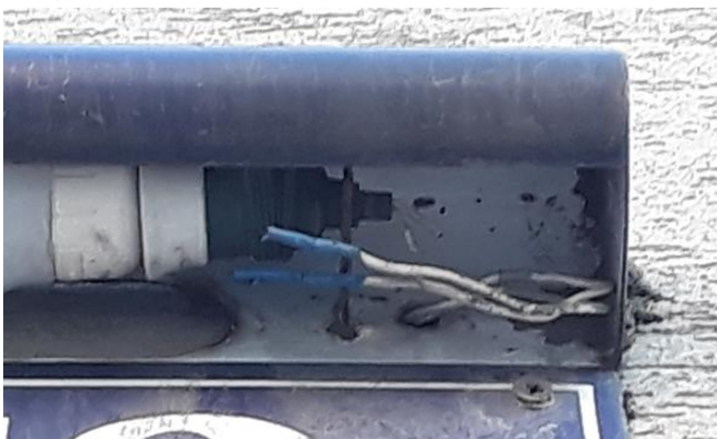
Abbildung 10: Abgetrennte und nur teilweise isolierte Stromleitung der Beleuchtung eines Orientierungsnummernschildes
