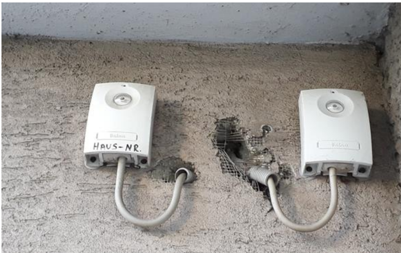
Abbildung 8: Ausgebrochene Stellen in einer Fassade, die nach der Montage von Dämmerungsschaltern nicht mehr verschlossen wurden
