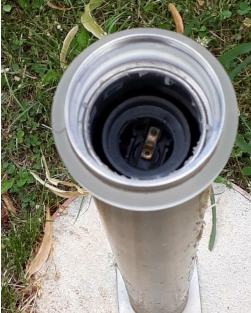
Abbildung 12: Defekte Pollerleuchte mit am Kopf offenem und damit ungeschütztem freiem Zugang zu den elektrischen Kontakten
