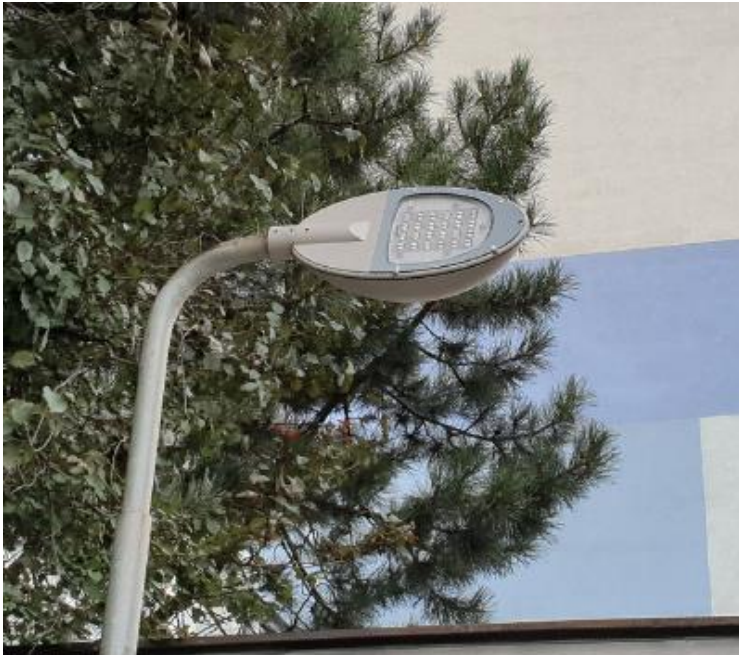
Abbildung 4: Verdrehte Leuchte einer Außenbeleuchtungsanlage
