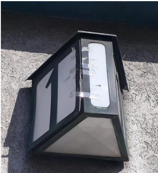
Abbildung 11: Mit Klebeband zusammengehaltenes Gehäuse einer beleuchteten Stiegennummer
