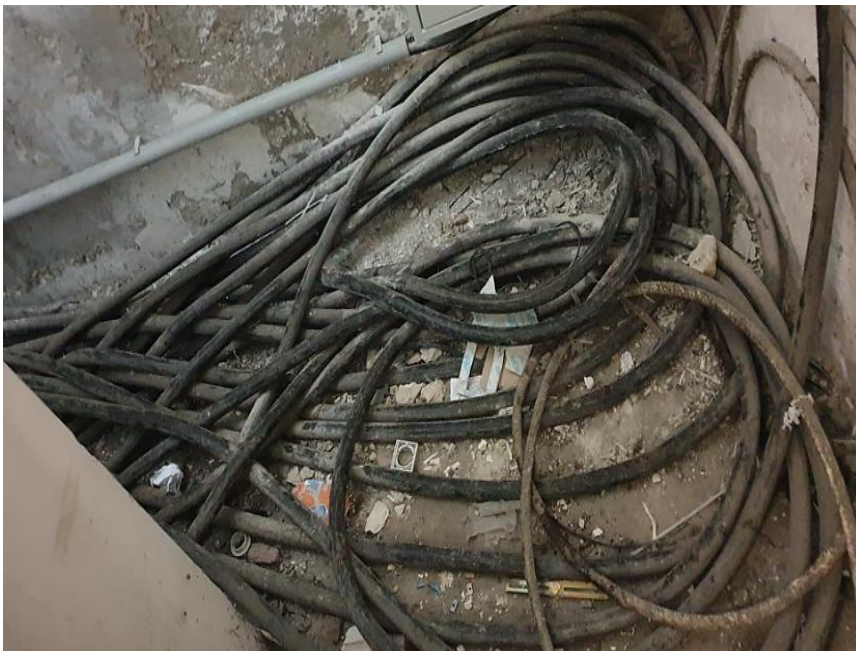
Abbildung 3: Unsachgemäße Verlegung von Kabeln in einem Elektroverteilterraum
