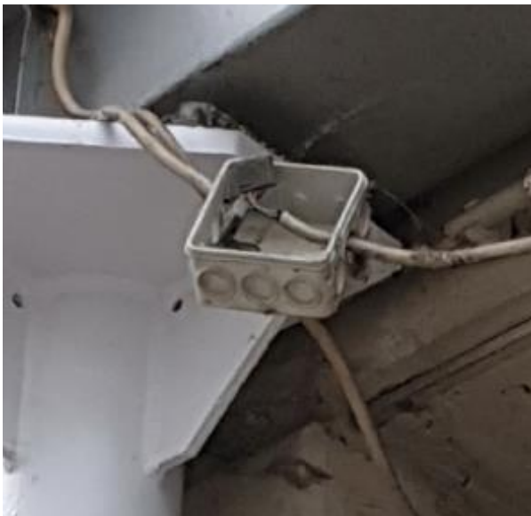
Abbildung 5: Offene Verteilerdose im Freien
