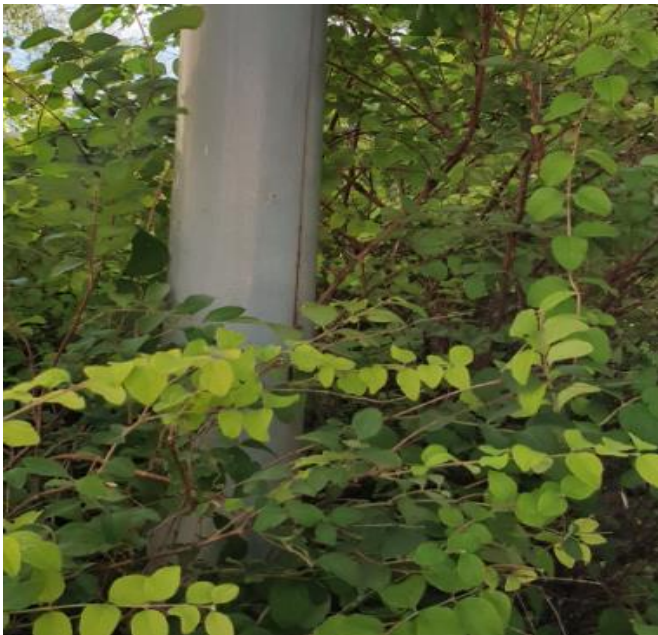
Abbildung 9: Durch Grünwuchs behinderter Zugang zur Revisionsöffnung eines Mastes
