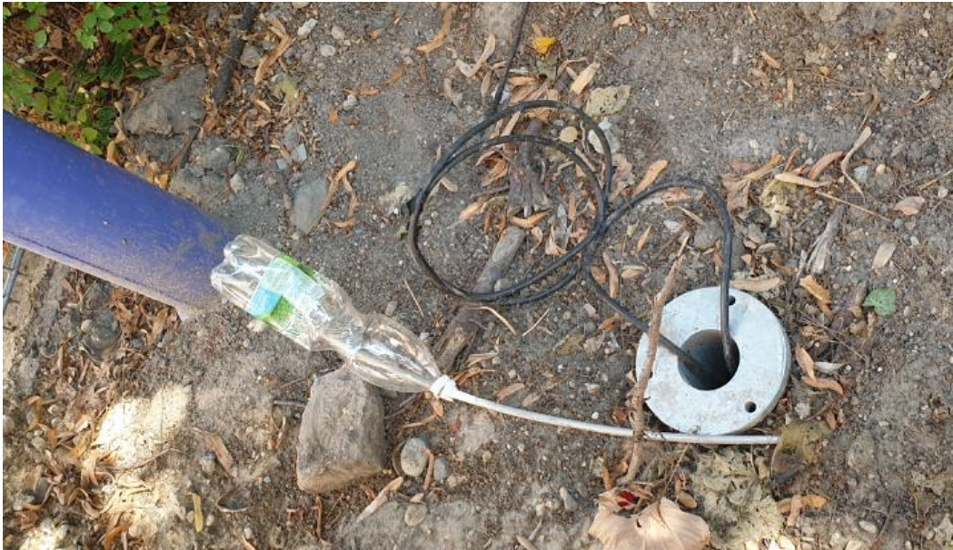
Abbildung 2: Unsachgemäße Verlegung von Kabeln im Bereich eines Kindergartens
