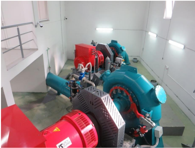
Abbildung 7: Kraftwerk Rujevica Ušće - Innenansicht
