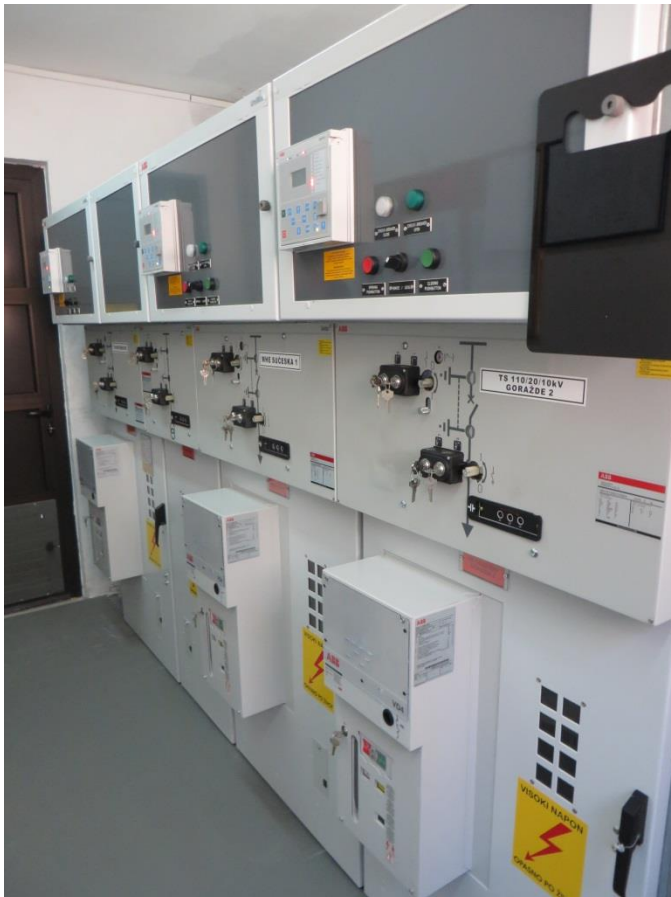
Abbildung 18: Kraftwerk Sućeska RS-2 - Innenansicht (Steuerungseinheit)
