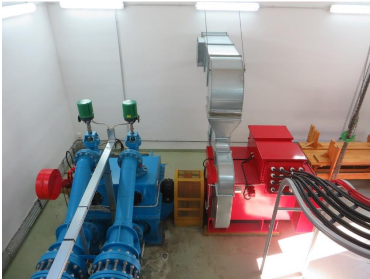
Abbildung 17: Kraftwerk Sućeska RS-2 - Innenansicht (Turbine)
