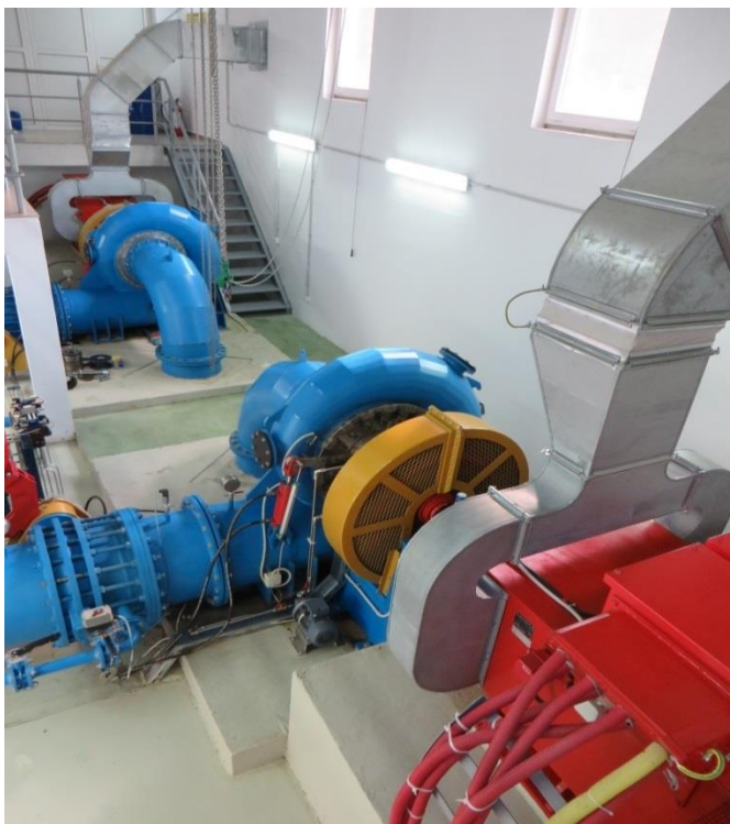
Abbildung 10: Kraftwerk Botašnica Ušće - Innenansicht
