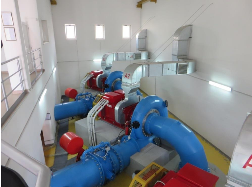
Abbildung 5: Kraftwerk Čardak - Innenansicht
