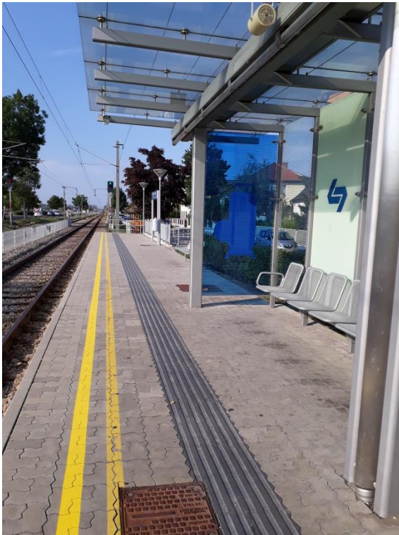
Abbildung 14: Unklare Anbringung der gelben Sicherheitslinie in der Haltestelle Möllersdorf, Lokalbahn, aufgenommen am 26. August 2019
