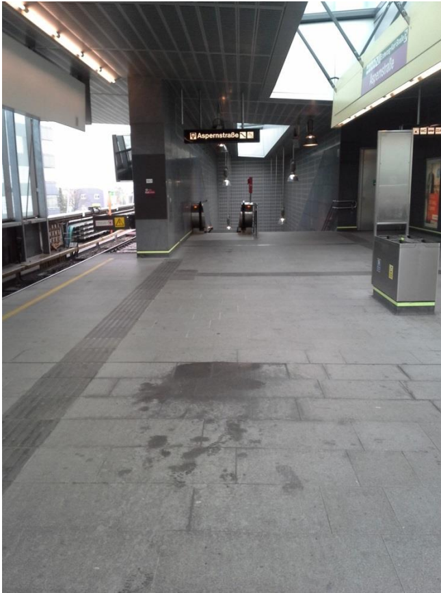
Abbildung 12: Wassereintritt durch das Dach über dem Bahnsteig, Foto vom 20. Oktober 2015
