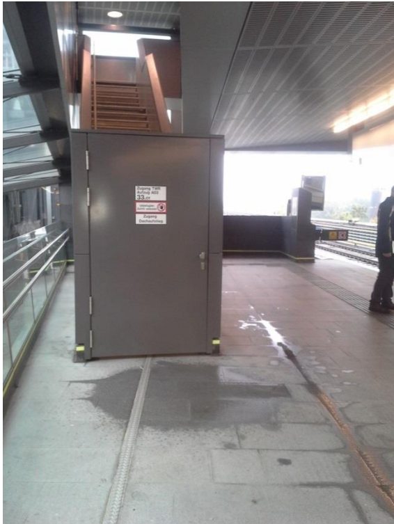
Abbildung 8: Wassereintritt durch das Dach über dem Bahnsteig, Foto vom 20. Oktober 2015
