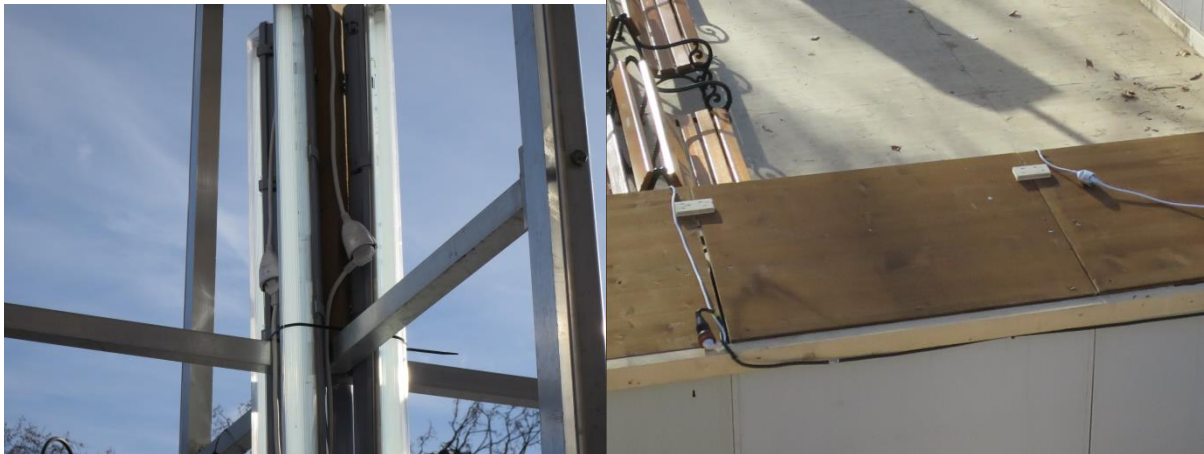
Abbildungen 7 und 8: Ungeeignete Schukosteckverbindungen
