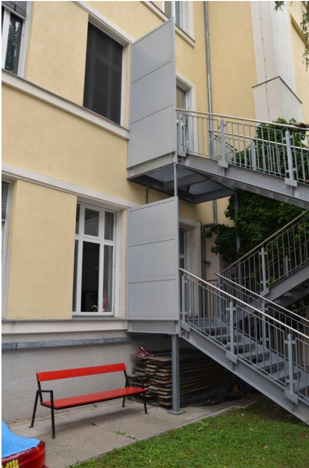
Abbildung 1: Lagerung unter der Fluchttreppe
