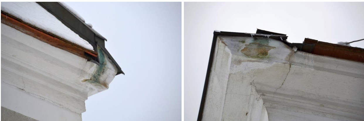
Abbildungen 6 und 7: Schäden am Mauerwerk aufgrund mangelhaft hergestellter Attikaverblechung
