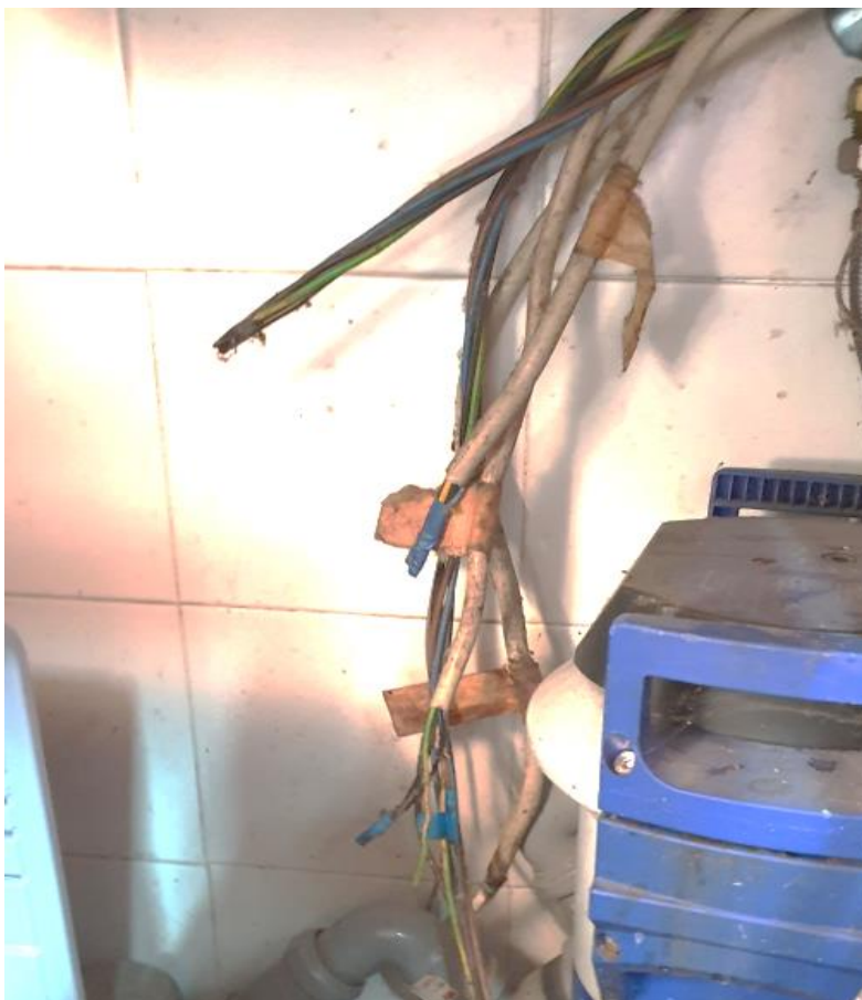
Abbildung 2: Lose herabhängende, jedoch isolierte Kabelenden
