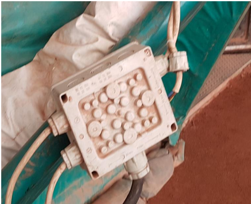
Abbildung 1: Unsachgemäße Montage einer Verteilerdose
