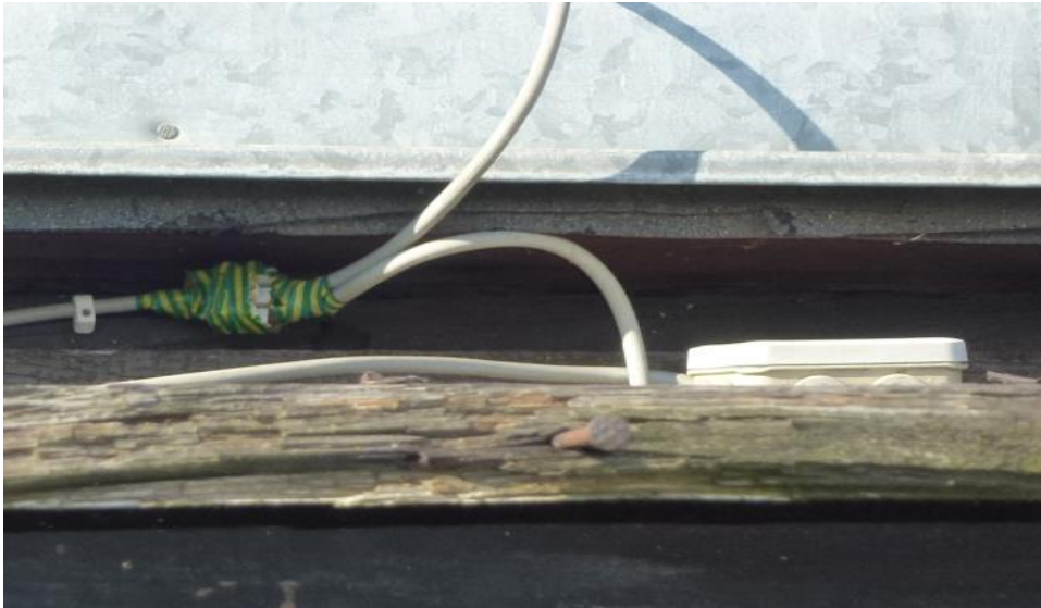
Abbildung 2: Unsachgemäße Verzweigung von Kabeln im Freien
