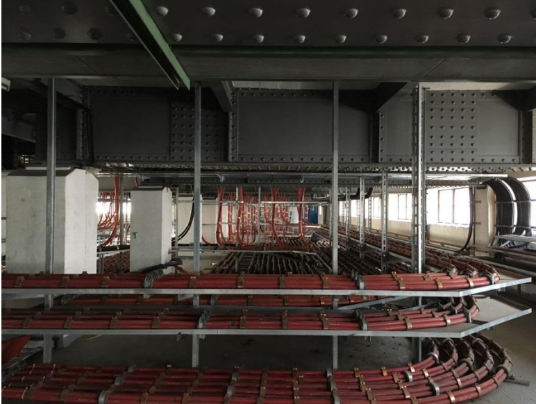
Abbildung 17: Umspannwerk Favoriten - Innensicht 2
