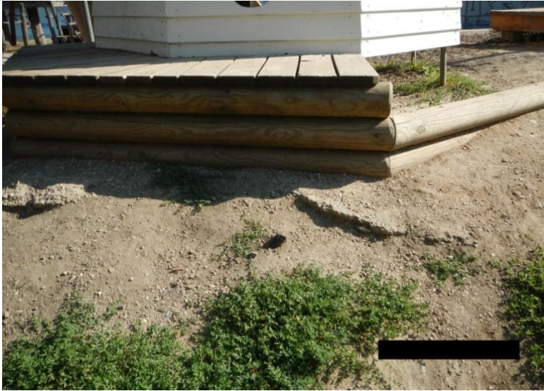
Abbildung 4: Oberflächenproblematik im Bereich "Leuchtturm", Wasserspielplatz Max-Winter-Park
