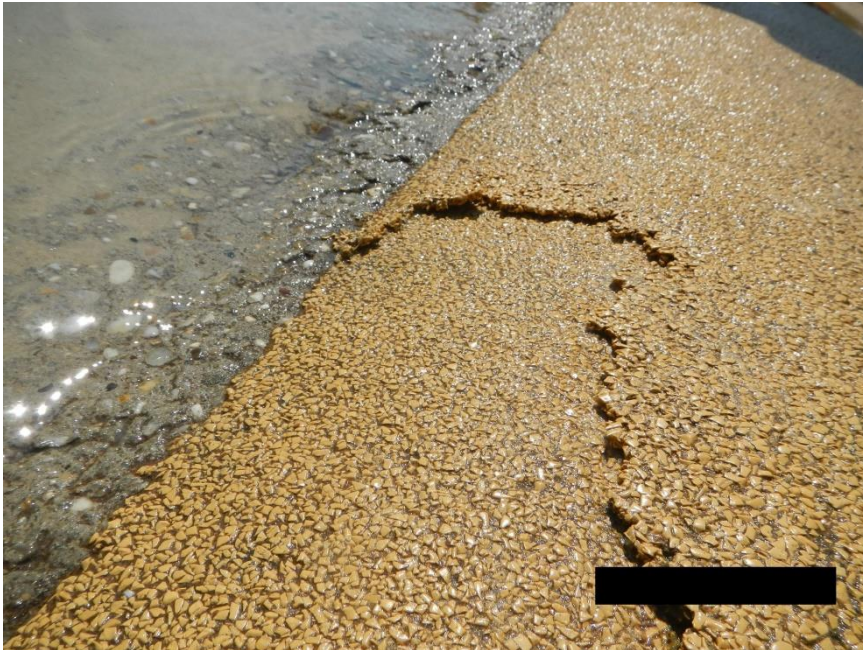
Abbildung 1: Schaden Granulatbelag (exemplarisch) - Teichufer, Wasserspielplatz Wasserturm
