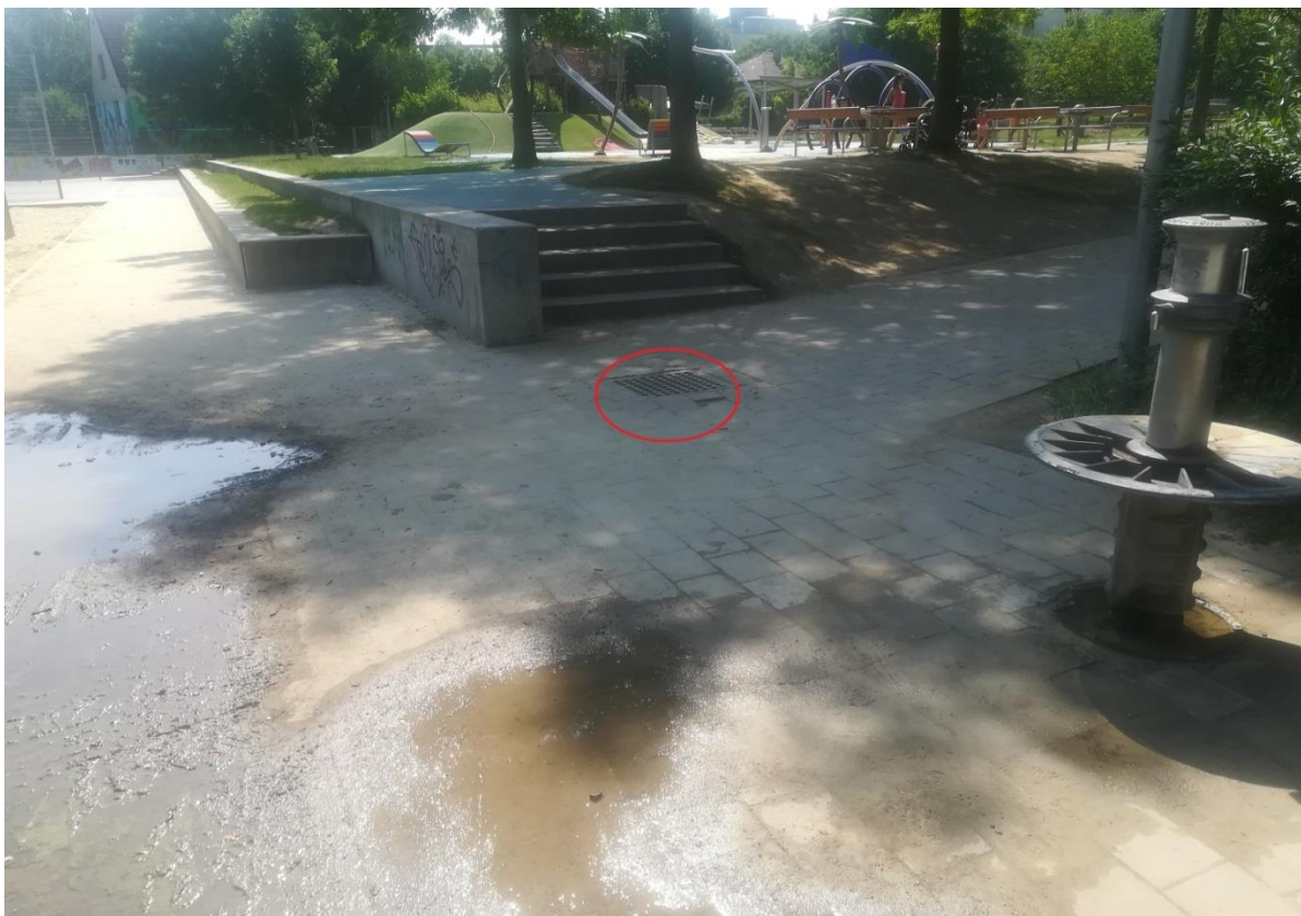
Abbildung 3: Abflussproblematik infolge niveauhöheren Ablaufschachts, Wasserspielplatz Leberberg
