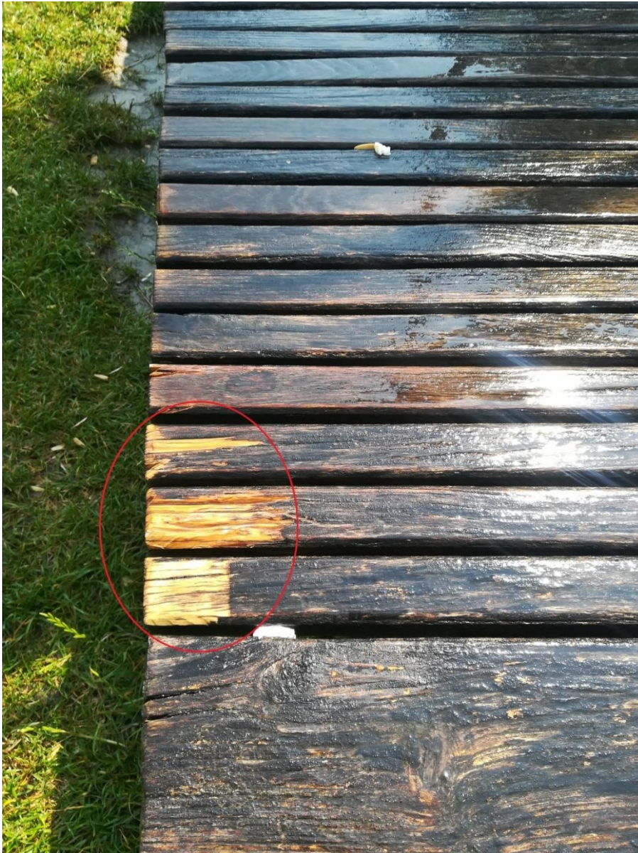
Abbildung 2: Holzabsplitterung Sonnendeck, Wasserspielplatz Wasserturm
