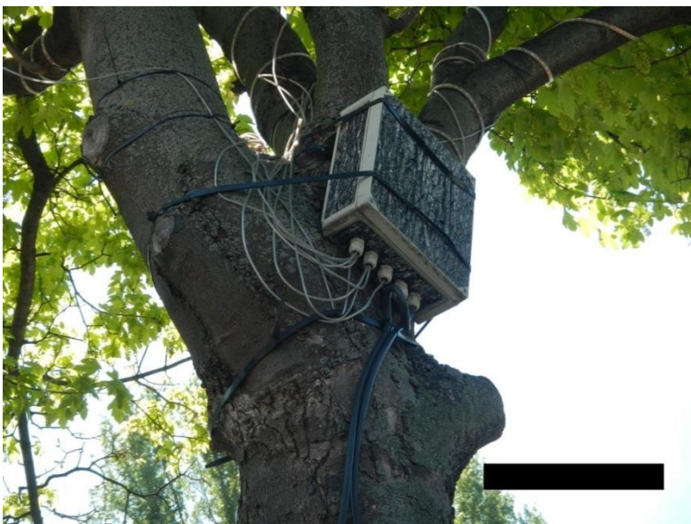
Abbildung 15: Nicht normgemäß ausgeführte Befestigungen
