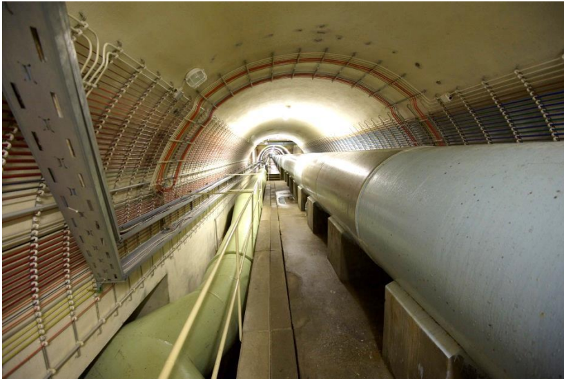
Abbildung 5: Verbindungskorridor mit quellwassergefülltem Rohr und teils inaktiver Elektroverkabelung
