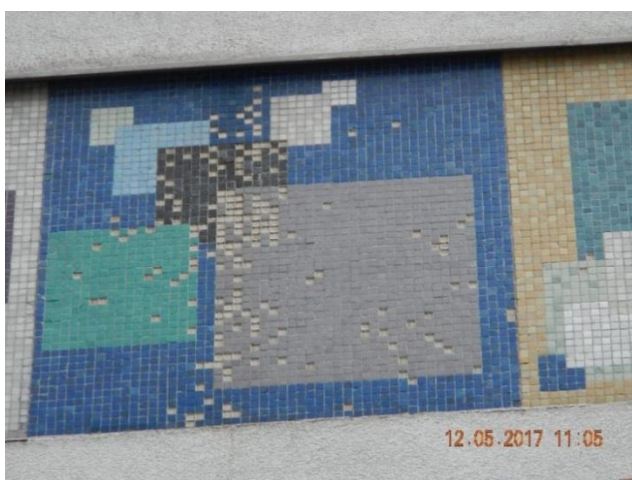
Abbildung 16: Fehlen von Mosaiksteinen
