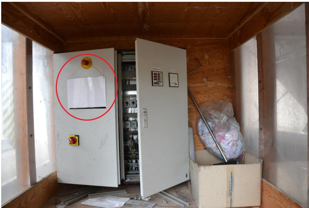
Abbildung 6: Elektroverteiler einer Befüllanlage
