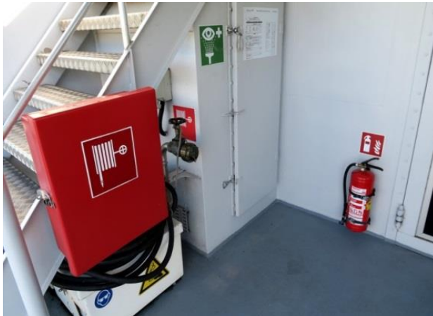
Abbildung 6: Handfeuerlöscher und Wandhydrant
