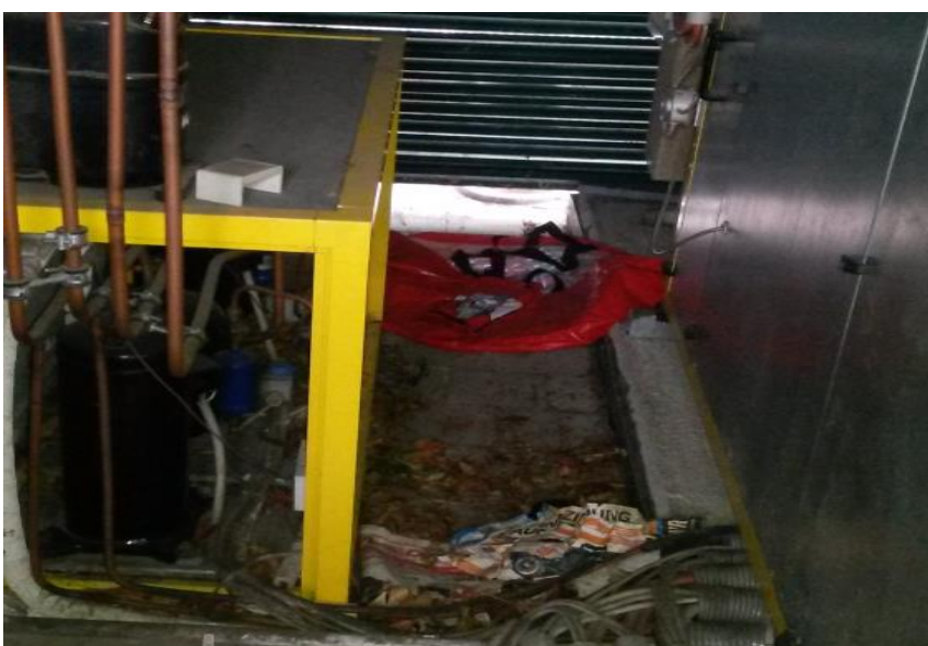
Abbildung 4: Verschmutzung im Lüftungsbauwerk durch eine Mieterin eines Geschäftslokals im Stationsbauwerk Schottenring
