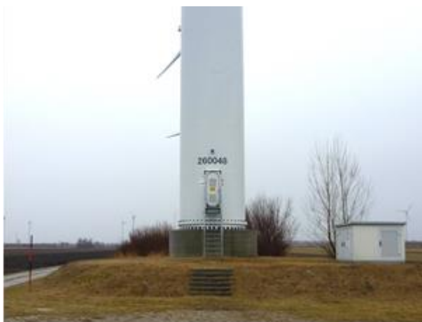
Abbildung 10: Überschüttete Fundamentplatte und Transformatorstation
