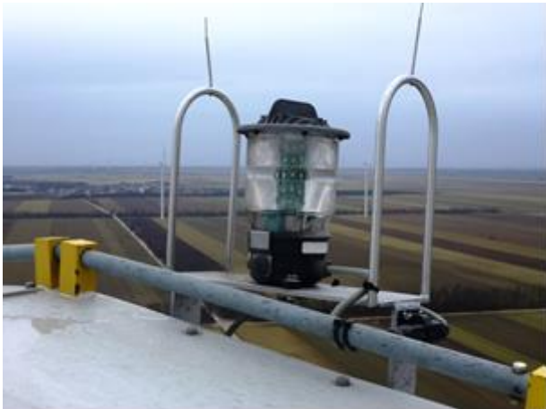
Abbildung 9: Blitzfangstangen neben Warnlampe auf dem Maschinengondeldach
