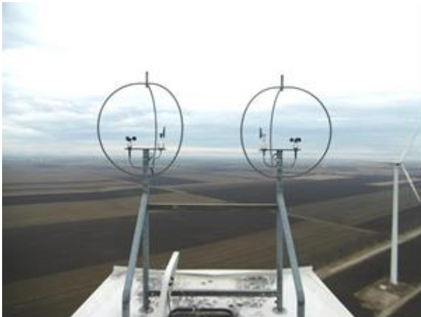
Abbildung 8: Wetterstation am Maschinengondeldach
