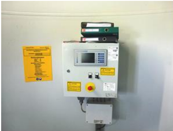
Abbildung 11: Steuerungs- und Überwachungsanlage
