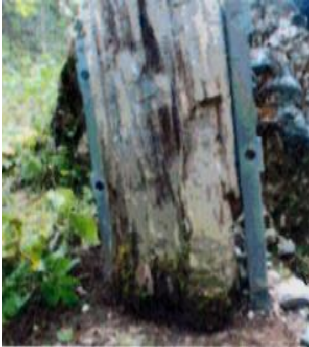
Abbildung 2: Beginnende Holzfäule beim Stützenfuß (Mittelstütze)
