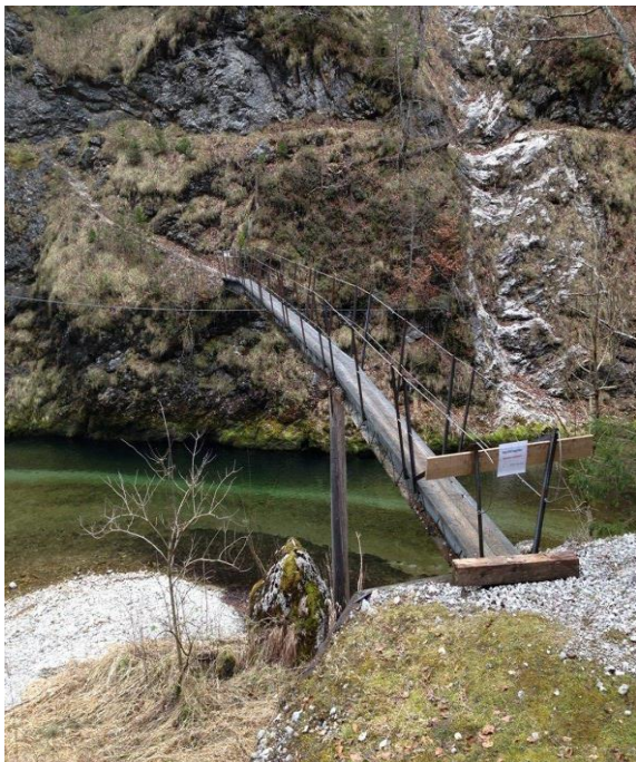
Abbildung 1: Gesperrter Klausgrabensteg vor Sanierung
