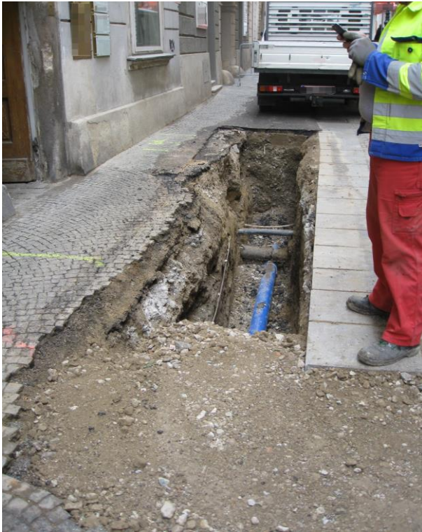
Abbildung 3: Offene Künette mit ungesichertem Hauseingang
