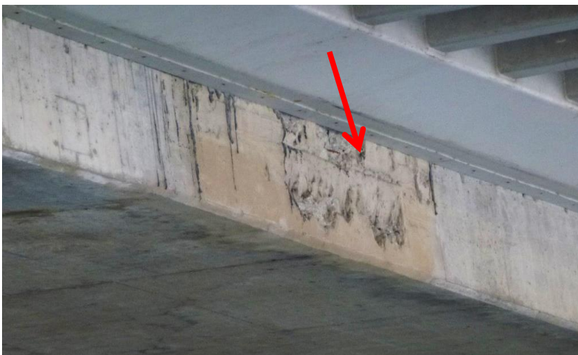
Abbildung 19: Betonabplatzungen am Randbalken im Bereich des linken Pfeilers der Neuen Donau
