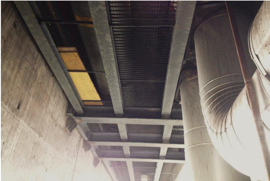
Abbildung 8: Provisorische Abdeckung eines fehlenden Elementes beim Gitterrostboden
