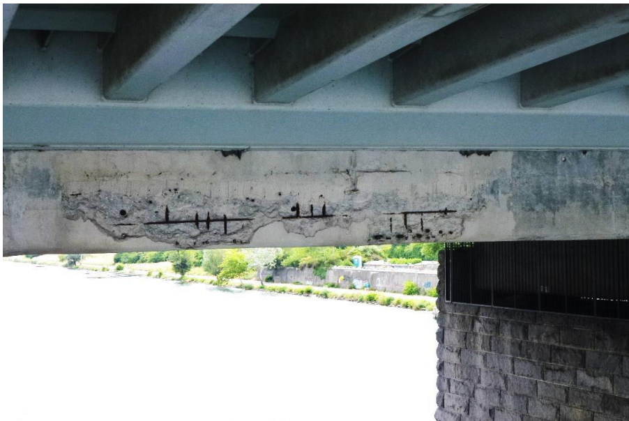
Abbildung 20: Betonabplatzungen am Randbalken im Bereich des rechten Pfeilers der Neuen Donau
